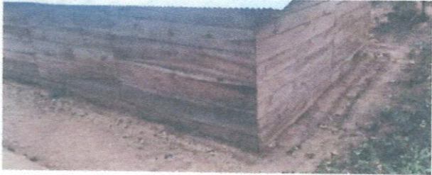
Foto1: Paredes en mal estado, no aptas.
