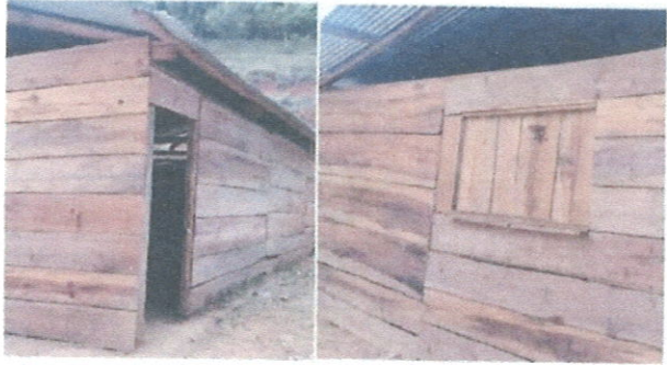
Foto 4: Puerta y ventanas poco seguras y de medidas no aptas para la movilidad y ventilación de un aula
