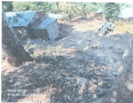
Foto 6: cerco perimetral en malas condiciones, se considera un peligro para la integridad física para los alumnos
